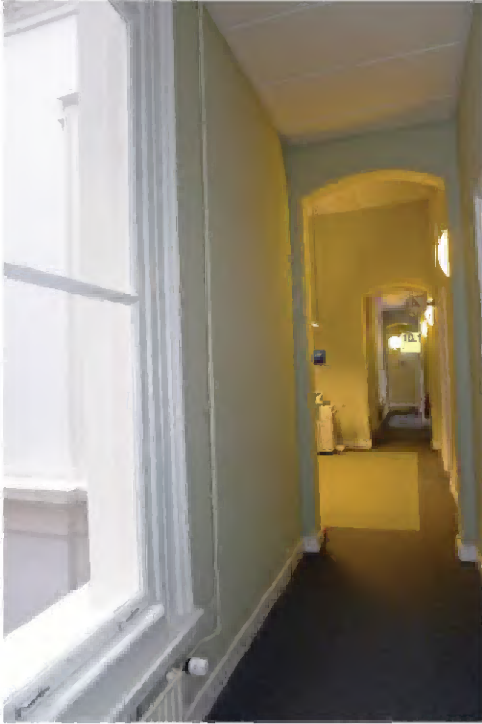
44 Gang aan de westzijde van de noordelijke binnenplaats, gezien in zuidelijke richting; de wand dateert uit 1883 (afsluiting binnenplaats).
