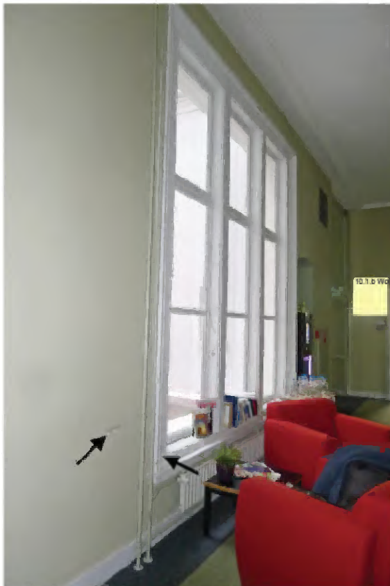
26 Interieur eerste verdieping met onderzoekspunten wand en venster aan oostzijde van noordelijke binnenplaats. Wand en venster behoren tot bouwfase 1859.
