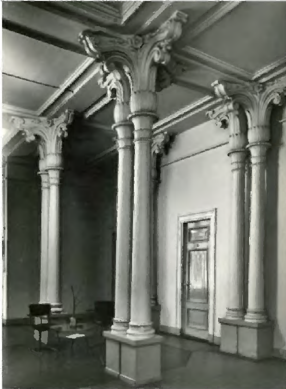
10a De hal op de eerste verdieping in 1969 met viertal gietijzeren kolommen uit 1859. Basement is donkerder van kleur dan de kolom. (Herkomst foto: Polderman 2019)
