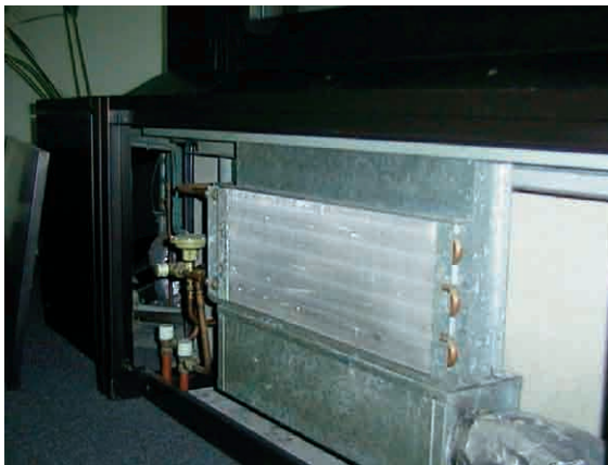
Inductie-unit in Conditie 2
