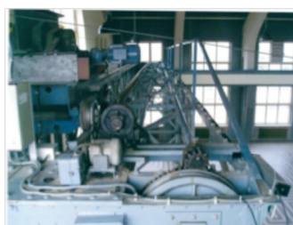
Loopkraan van historische waarde * in zendstation Kootwijk (1920) met handtakel en later toegevoegde elektromotor
