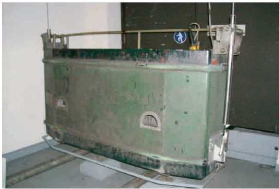
Gondel gevelonderhoudinstallatie in conditie 3
