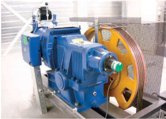
Liftaandrijving in conditie 1
