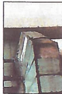
gevelgevelwerk laat los
