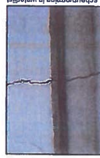
scheurvorming in waterlijst
