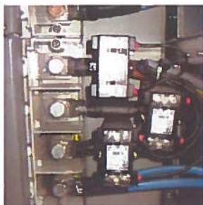
Foto: afdekking is ingekort in verband met hoogte stroomtransformatoren
