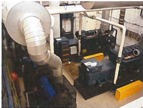
Foto: bovenaanzicht kelder -2, opstelling noodstroom aggregaten
