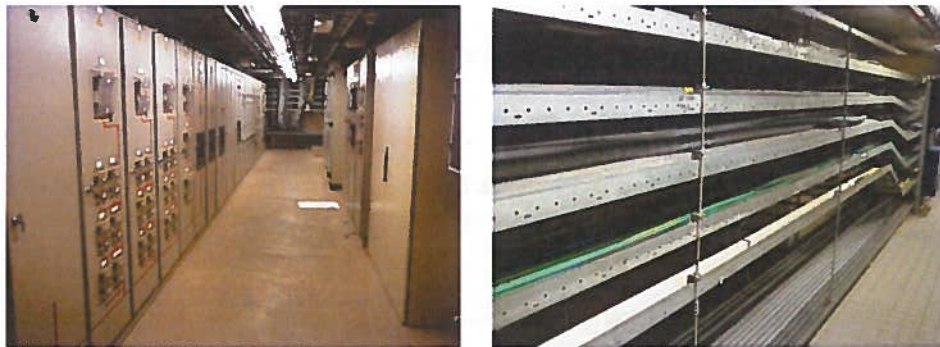
Foto: kabeltracés in laagspanningsruimte overgaand in de leidingstraat
