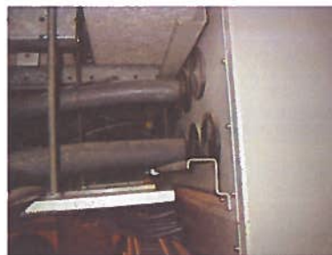
bovenzijde kabel tracé
