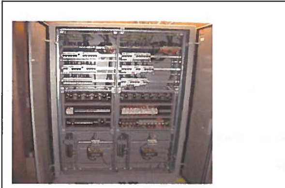
Foto schakel en verdeelinrichting open / dicht
