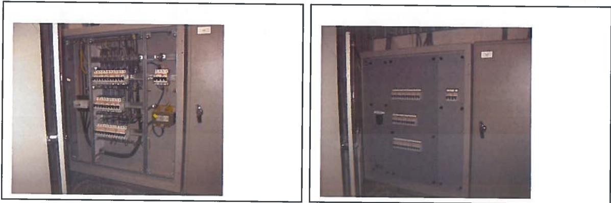
Foto schakel en verdeelinrichting open / dicht
