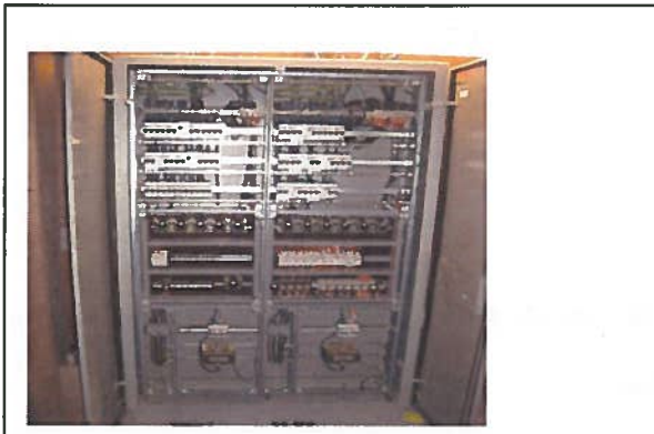
Foto schakel en verdeelinrichting open / dicht
