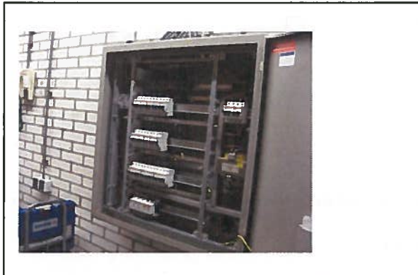
Foto schakel en verdeelinrichting open / dicht
