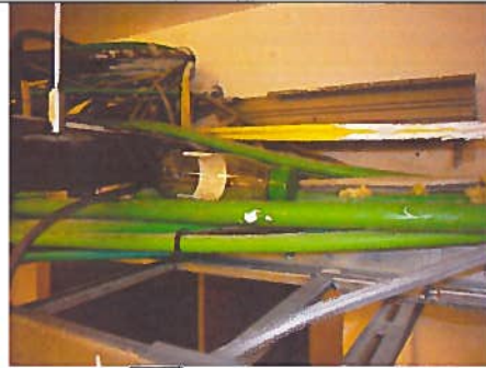
Foto 26 – [REDACTED] Volle kabelgoot en brandwerende doorvoering?
