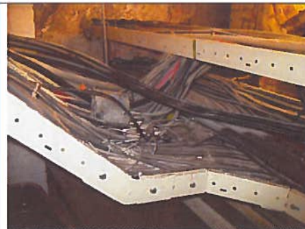
Foto 48 – Volle kabelgoot en brandwerende doorvoering?
