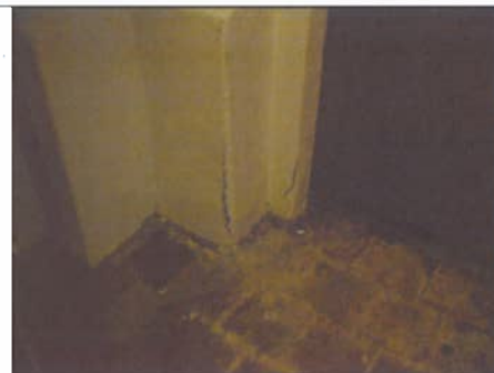
Foto 50 – Loslatend pleisterwerk vlak boven de keldervloer, waarschijnlijk als gevolg van vochtproblemen
