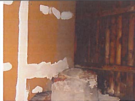
Foto 46 – Sporen van lekkage
