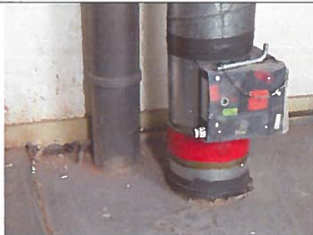
Foto 59 – Brandwerende doorvoering. Rechts wel en links niet?
