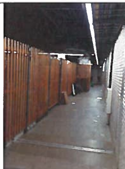
Foto 64 – Nieuwbouw opslag in technische ruimte
