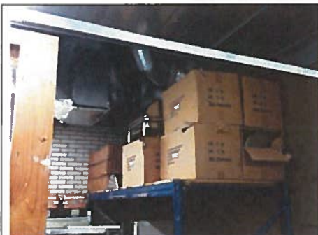
Foto 63 – Nieuwbouw opslag in technische ruimte
