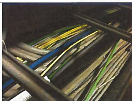
Foto 68 – Nieuwbouw volle kabelgoot
