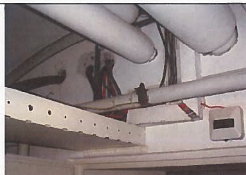
Foto 6 – ontbreken brandwerende doorvoeringen
