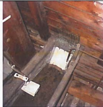
Foto 2 – beluchting / waterafvoer zolder
