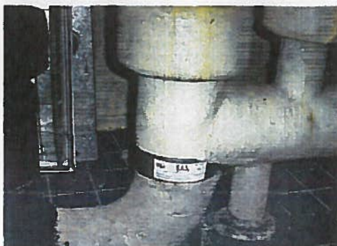
Foto 21, M-18 isolatie, bevat geen asbest
