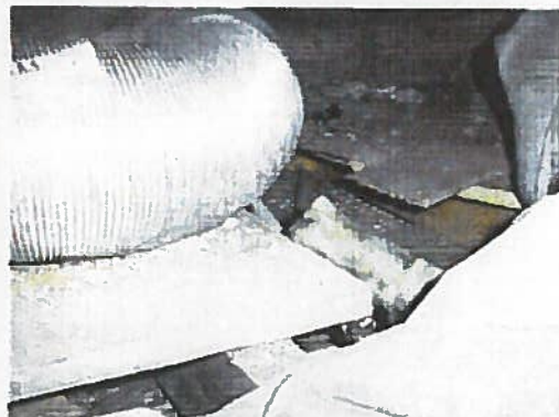
Overzichtsfoto, resten asbest, 20 – 40% Chrysotiel.
