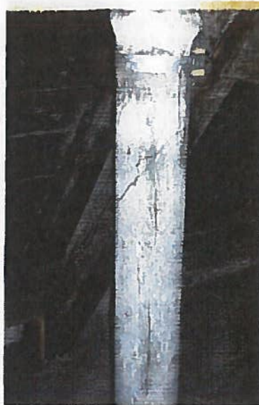
Overzichtsfoto, asbestkanaal bevat 20 – 40% Chrysotiel.
