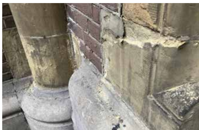
Aantasting natuursteen gevel Gebouw J
