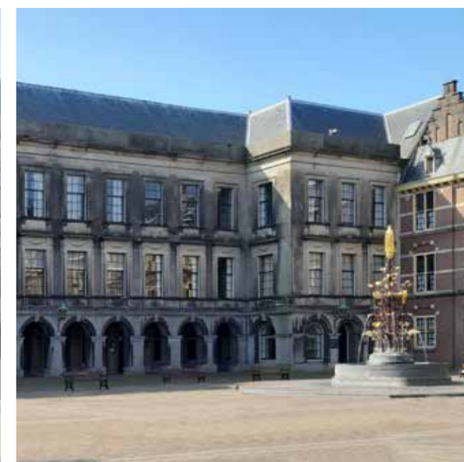
Huidig aanzicht van vervuilde gevel.
